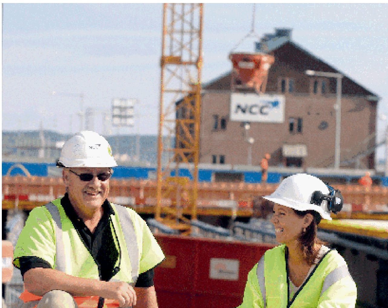
Ett av de större pågående anläggningsprojekten i Sverige under 2003 var byggandet av Götatunneln. Tunneln är en del av Götaleden som ska effektivisera trafikflöden i Göteborg. Tack vare partnering-liknande samarbete med kunden låg projektet hösten 2003 tre månader före tidsplan. Conny Johansson och Anna Norén är två av NCCs många medarbetare i projektet.
